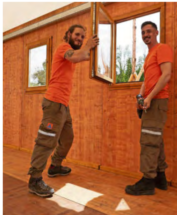
Die Zivildienstleistenden Martin Schmucki (links) aus Mönchaltorf und Mike Zimmermann aus Esslingen packen beim Bau des Turnstübls kräftig mit an.
